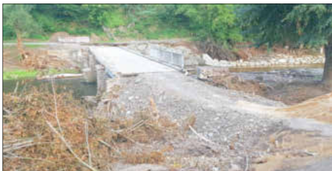
Brücke in Echtershausen im Juli 2021. Foto: Konder/Kreisverw.
